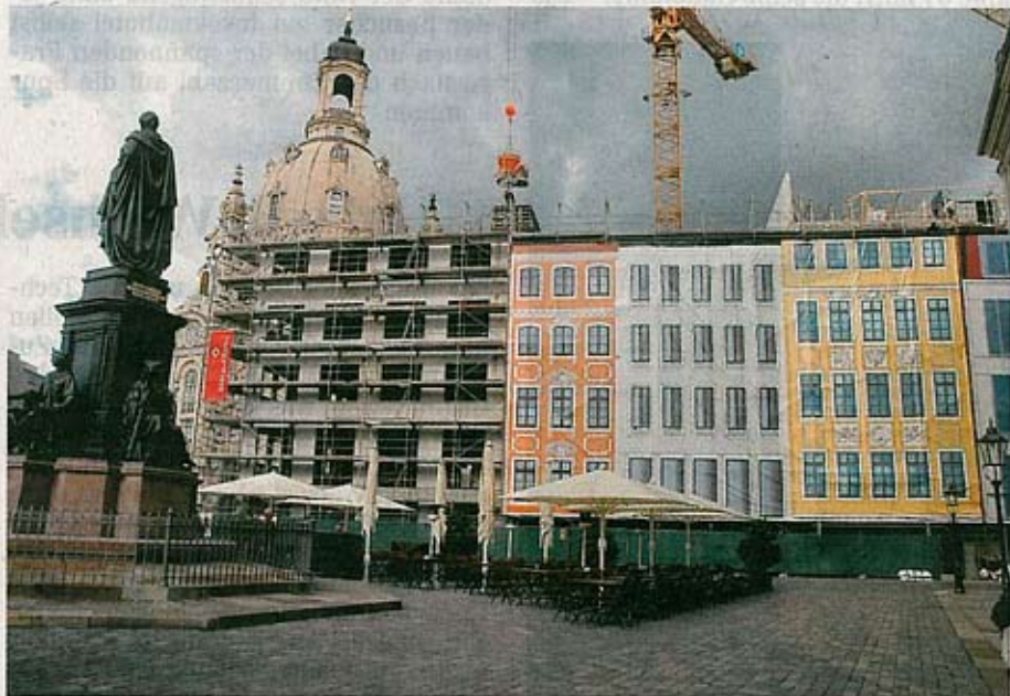
Sollen Vorfreude auf den Mai 2008 wecken: Die Planen zeigen, wie das Quartier III nach der Fertigstellung aussehen wird. Foto: Dietrich Flechtner
